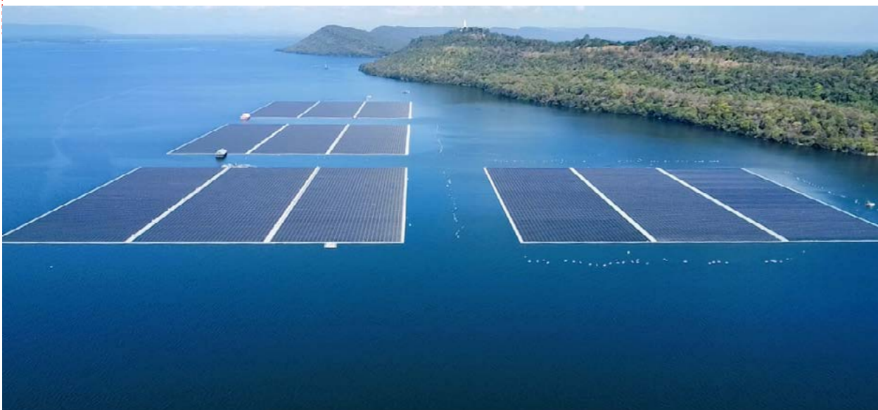
▲ 泰国乌汶叻水面光伏综合智慧能源项目
