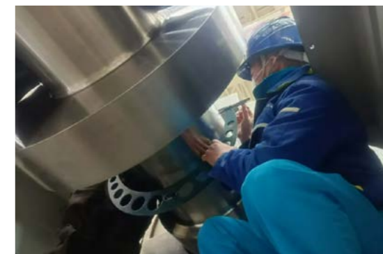
新疆哈密市重能哈密项目现场，东方汽轮机项目服务人员正在气温零下 10 度的环境下，执行汽轮机组安装技术指导服务工作，为机组早日高质量投运打下坚实基础。
